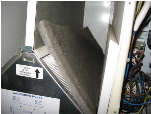
Kuva 8. Esimerkki puutteellisesti asennetusta ilmanvaihtokoneen ulkoilmasuodattimesta. Ulkoilma pääsee virtaamaan suodattimen ohi.
