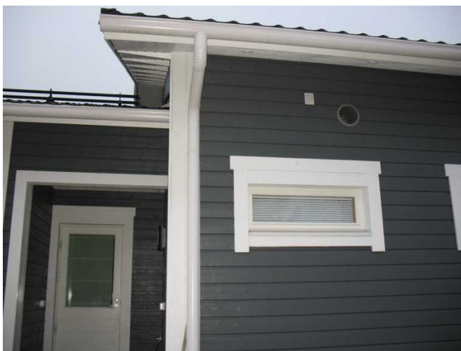
Kuva 20. Ilmanvaihdon ulkoilman sisäänottosäleikkö ja keskuspölynimurin jäteilman ulospuhallus ovat liian lähellä toisiaan. Keskuspölynimurin jäteilmaa ei tule myöskään puhaltaa oleskelualueille.
